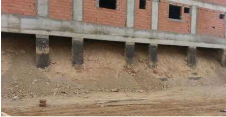
شكل (4) : انهيار تربة الردم تحت مبنى قائم بسبب إهمال سند الجوانب عند تنفيذ أعمال الحفر (رزق، 2014)
